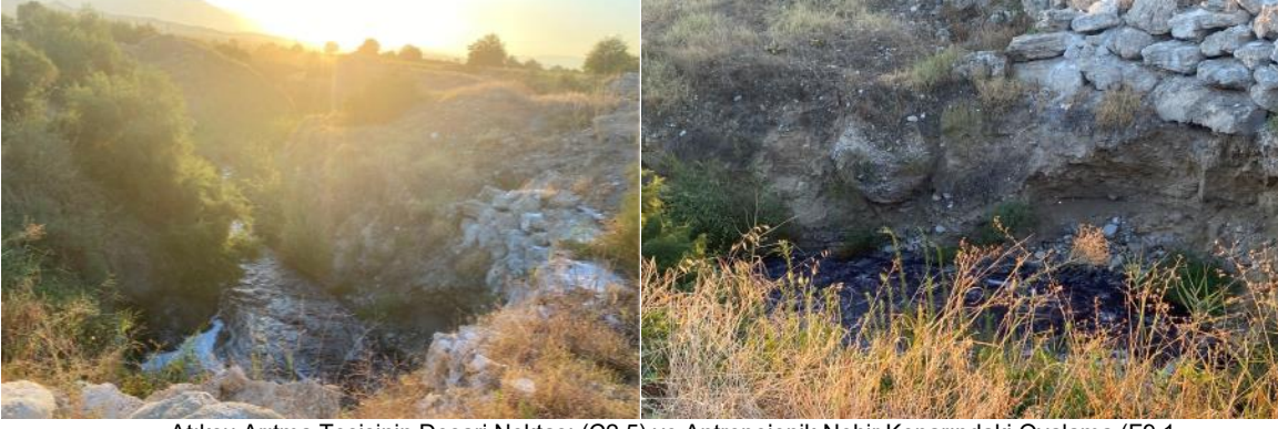
Atıksu Arıtma Tesisinin Deşarj Noktası (C2.5) ve Antropojenik Nehir Kenarındaki Ovalama (F9.1)
